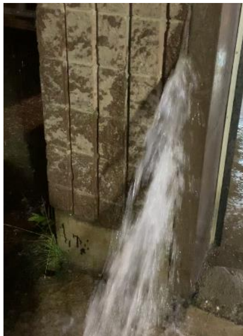
FIGURE 13 — Fortes pluies de juillet 2020 – de l'eau sort d'un mur adjacent à une porte de garage
