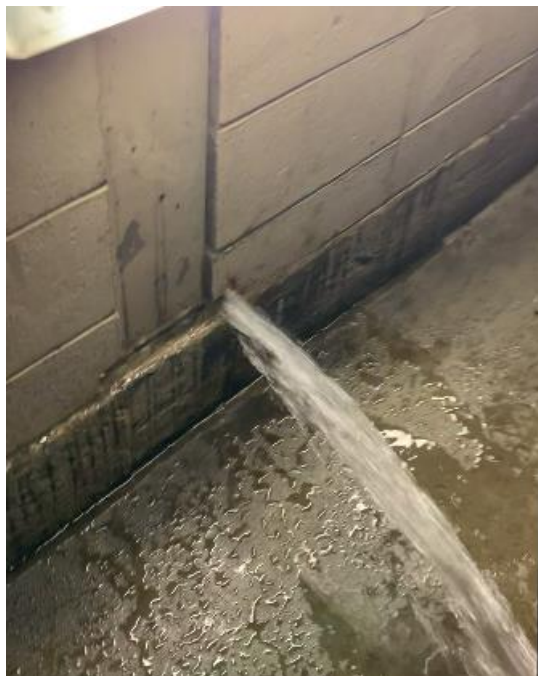
FIGURE 12 — Fortes pluies de juillet 2020 – de l'eau sort des murs de l'atelier
