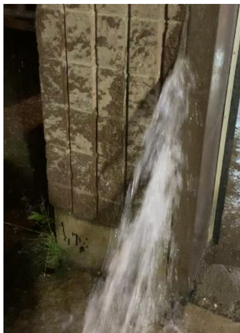
FIGURE 13 — Fortes pluies de juillet 2020 – de l'eau sort d'un mur adjacent à une porte de garage
