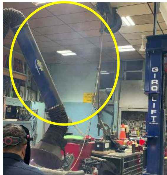
FIGURE 11 — Fumée visible non captée à la source
