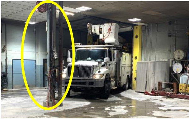
FIGURE 6 — Un poteau structural dans le milieu du garage, ce qui complique les manœuvres pour entrer et sortir les véhicules - risque d'accrocher le poteau
